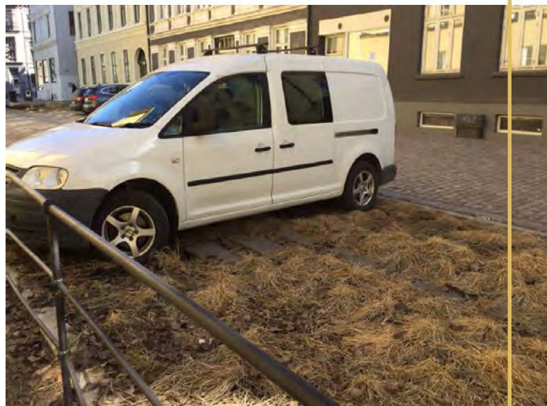
En «regnbed-fadder» kan melde ifra til kommunen om uønsket aktivitet i regnbedene, slik som parkering, kjøring eller oppbevaring slik at dette fanges opp og kan utbedres raskt og eventuelt belastes den som er skyld i skadene. Her er står en bil parkert i et av de vanlige plantebedene i Deichmans gate. Foto: Gerd Minde
