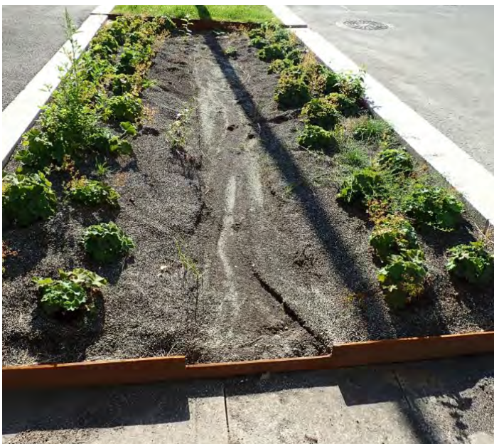
I dette anlegget er mye av vekstmediet vasket ut allerede før plantene har etablert seg. Erosjonsproblematikken kunne vært adressert med en stripe elvegrus i midten, bruk av ferdige staudematter eller ved å lede overvann utenom regnbedet i første vekstsesong.
