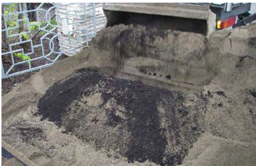
Ved anleggelse av regnbed NB21 i 2009 ble det blandet inn 5 % stedegen hagejord av god kvalitet sammen med sand og kompost. Regnbedet har vist seg å ivareta både tilstrekkelig infiltrasjon, vannlagringsevne og næringstilgang for plantene. Foto: Bent Braskerud
