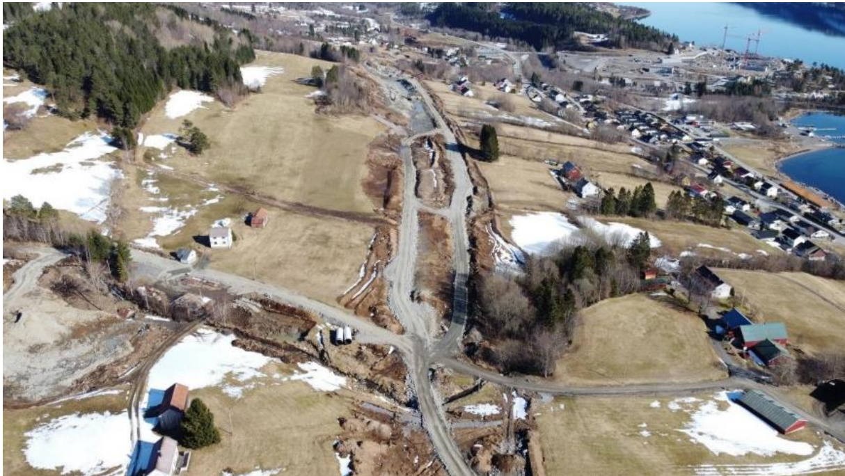
Figur 5: Foto som viser opparbeidelse av ny E39 sør for planområdet. Kilde: Statens vegvesen, Informasjonsmøte Ny E39 Lønset-Hjelset
