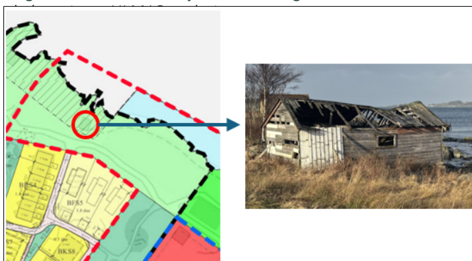
Figur 7: Eksisterende naust ved sjøen. Naustet er i dårlig stand.
